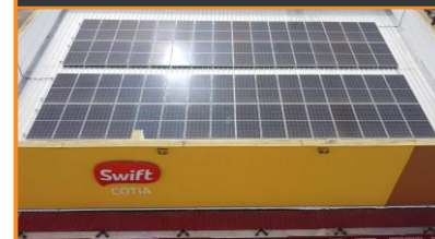
52. Cotia R. Tavares - 29,12 kWp
