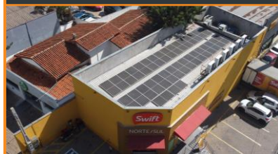
50. Norte Sul - 15,47 kWp
